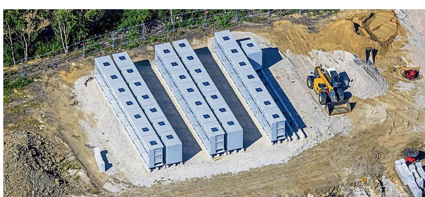
Stromspeicher an Windrädern können vermeiden, dass Energie bei Netzüberlastung verloren geht. Die Diemelseeer FDP will den Bau vorantreiben. Hier Speicher bei Heessen im Ruhrgebiet. FOTO: HANS BLOSSEY
