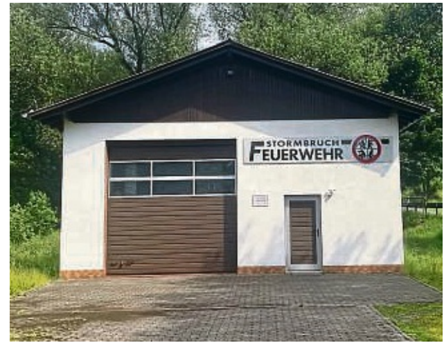
In Stormbruch sind schon 2025 Bauarbeiten vorgesehen, der bauliche Zustand gilt als schlecht. FOTO: FEUERWEHR
